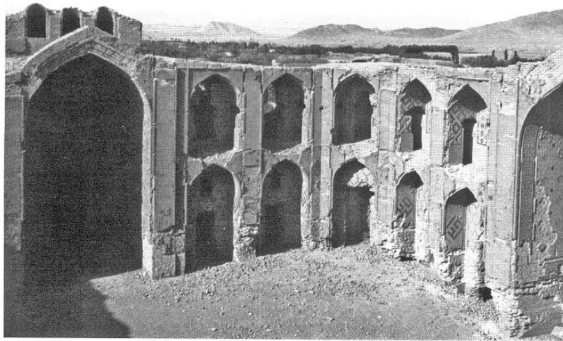
مدرسه غیاثیه خرگرد، سازه سالمی مورد بی توجهی واقع شده است. تاج امر هم قابل مشاهده است. سیستمی از معاینات منظم و برنامه‌ریزی‌های حفاظتی می‌تواند از این وضعیت نامناسب پیشگیری کند.
