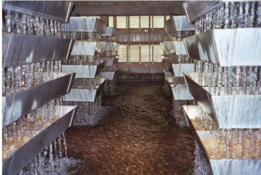
شکل 8- استفاده از برج های سینی دار در هوادهی آب
