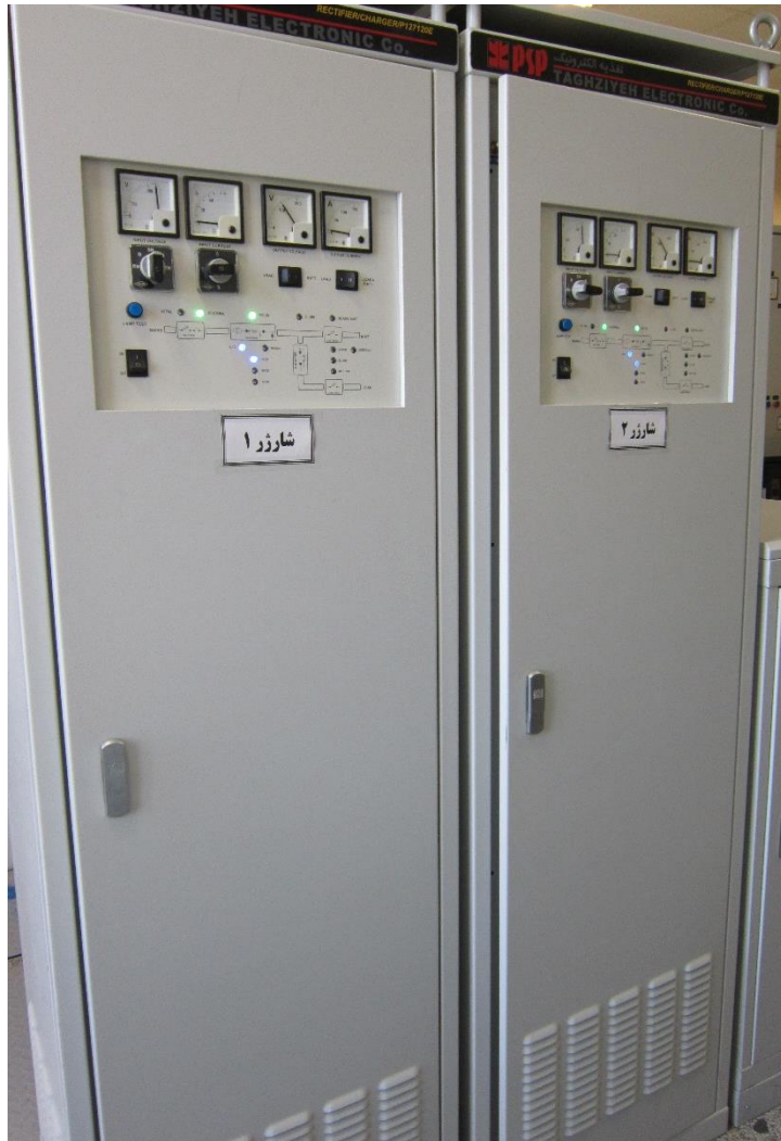
نمونه ای از شارژر ۱۱۰ ولت در یک پست
