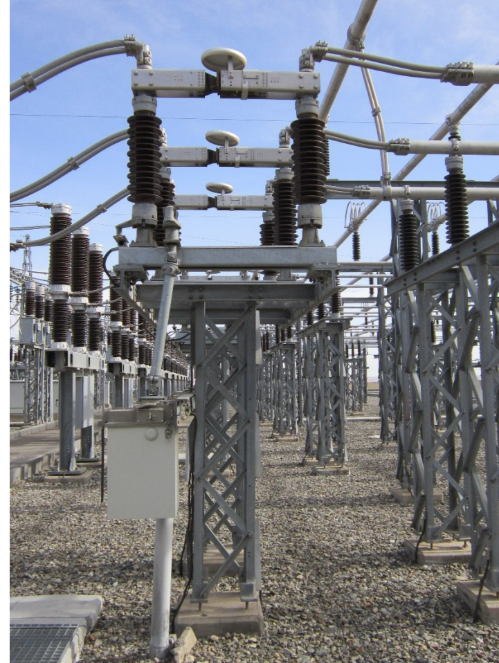
سکسیونر 63kV در یک پست
