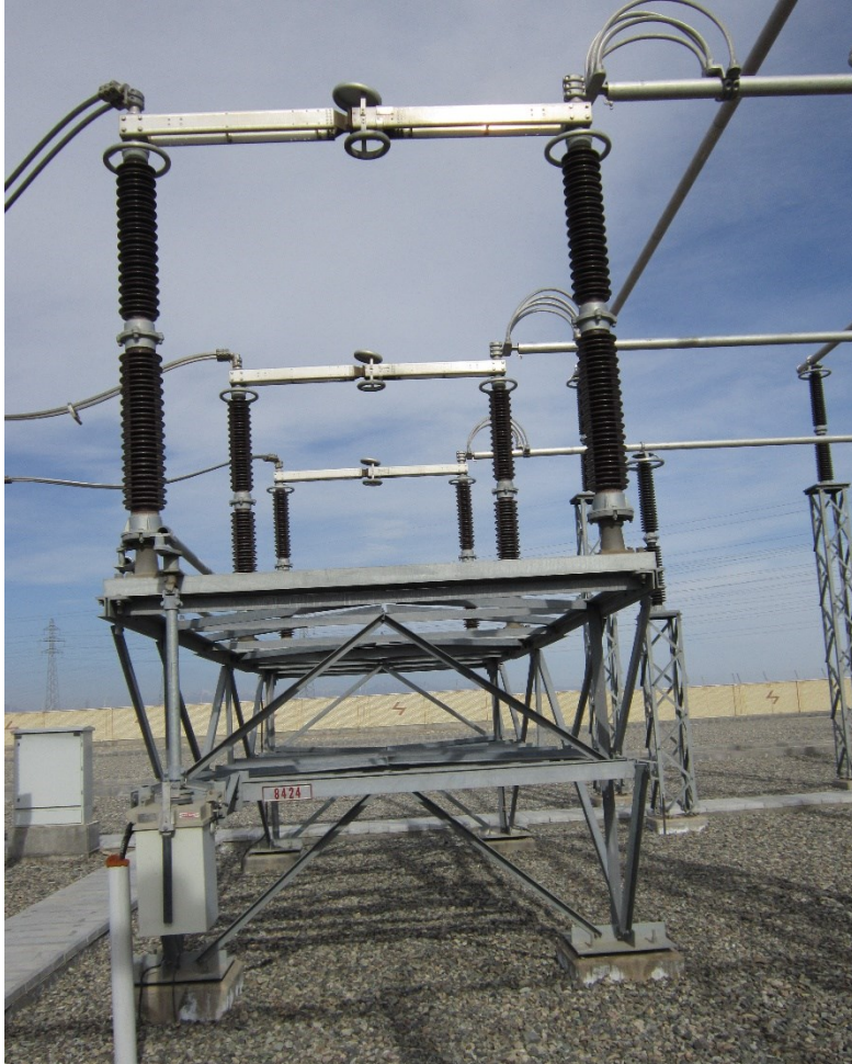
سکسیونر 230kV در یک پست
