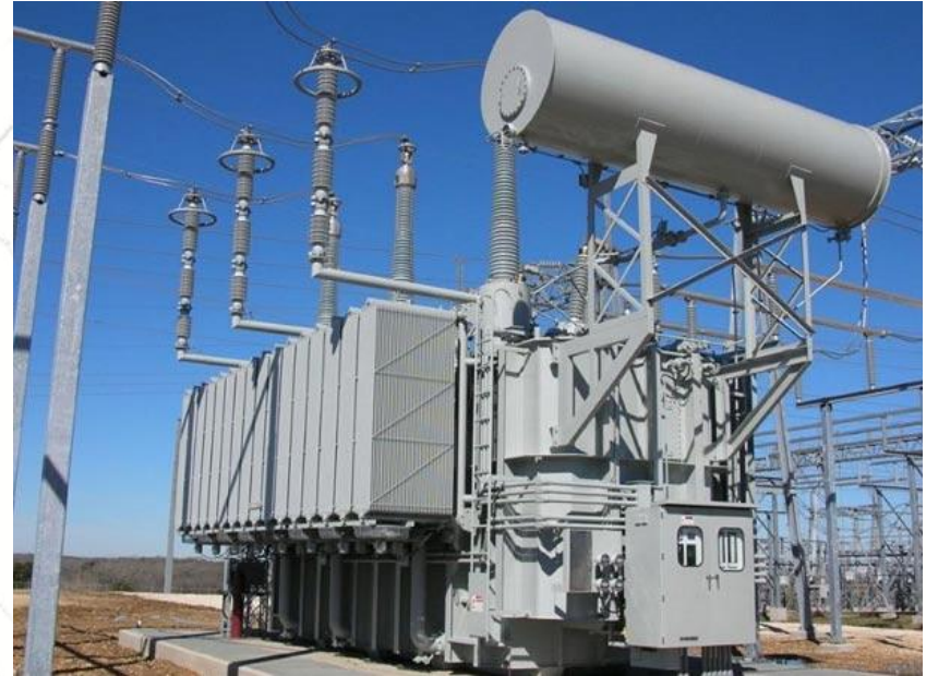
ترانس انتقال (ولتاژ ۲۳۰ kV و ۴۰۰)
