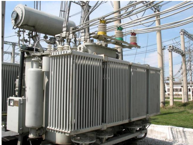
ترانس فوق توزیع (ولتاژ ۶۳ kV و ۱۳۲)
