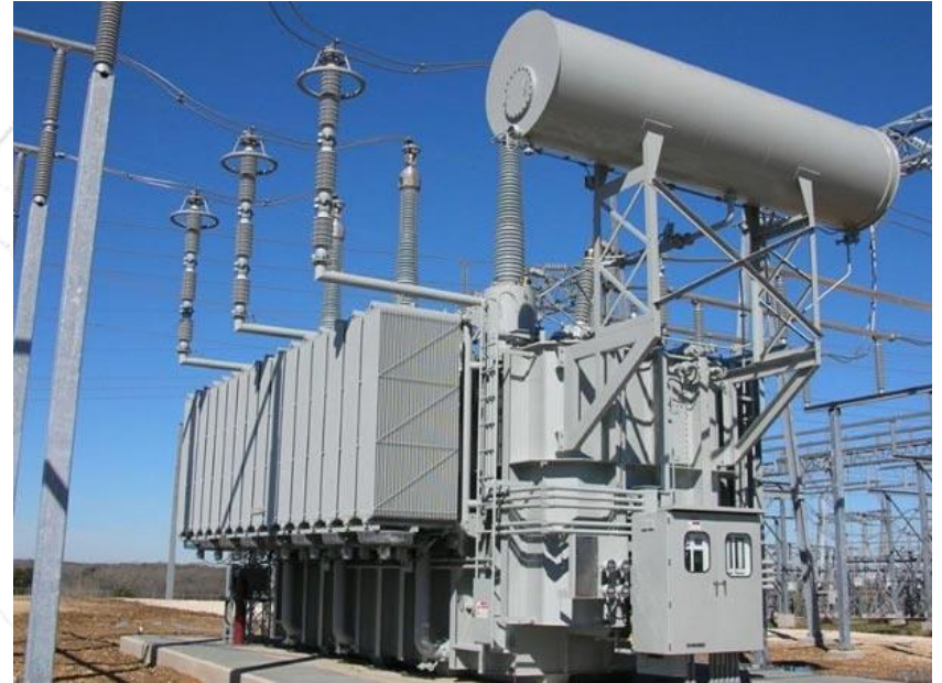
ترانس انتقال (ولتاژ ۲۳۰ kV و ۴۰۰)
