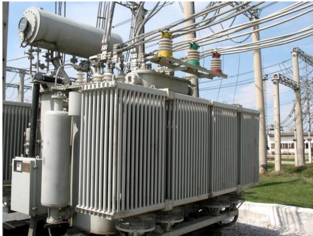
ترانس فوق توزیع (ولتاژ ۶۳ kV و ۱۳۲)
