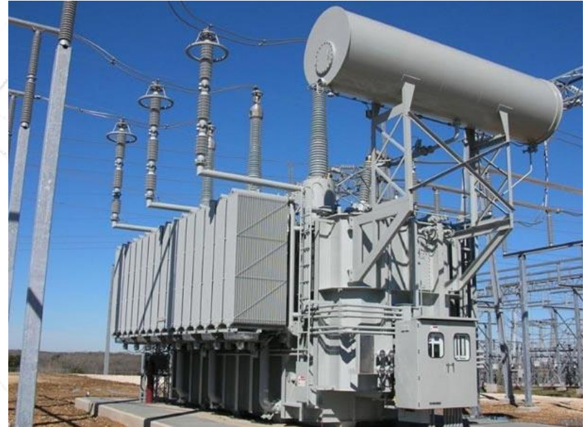
ترانس انتقال (ولتاژ ۲۳۰ kV و ۴۰۰)
