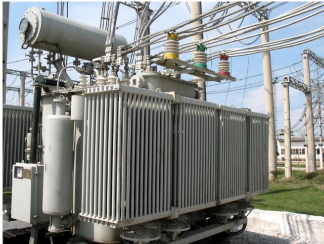
ترانس فوق توزیع (ولتاژ ۶۳ kV و ۱۳۲)
