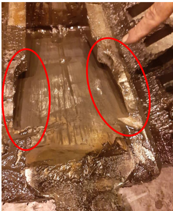
شکل (۳): محل شکستگی در سگمنت معیوب
